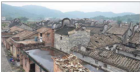
有 720 年历史的“广东最美古民居”上岳古民居建筑群在一次冰雹风灾中受损 13 (来源：人民网，2013)
